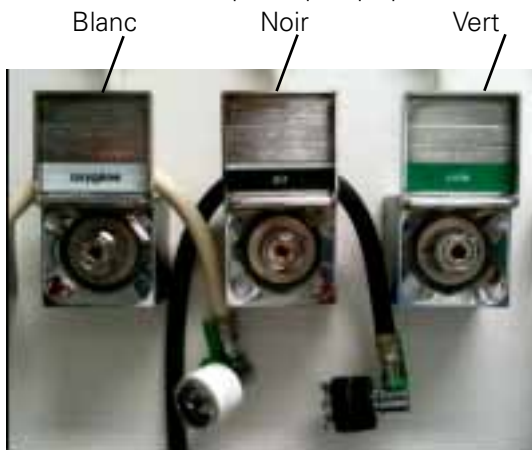
Figure 1 : Connecteurs des gaz médicaux et de vide : prise murales indémontables et prises scellées sur tuyaux souples, couleurs normalisées.
